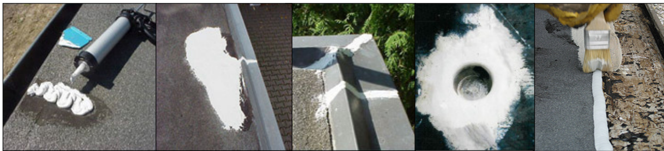
Bild 1+2 Luftblase aufgeschnitten, mit PU-Masse aufgefüllt. - Bild 3, Zinknähte abgedichtet. - Bild 4, ein mit PU-Masse modellierter Gully. - Bild 5, Bitumen – Metallkante Nahtabdichtung
